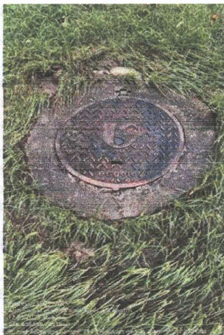
Figura 01. Bueiro do qual extravasaram-se os efluentes.
