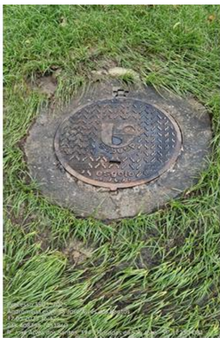
Figura 01. Bueiro do qual extravasaram-se os efluentes.
