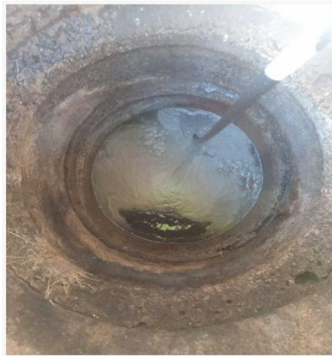
Figura 2 – Poço antes da desobstrução e remoção de resíduos presentes na rede coletora de esgoto.
