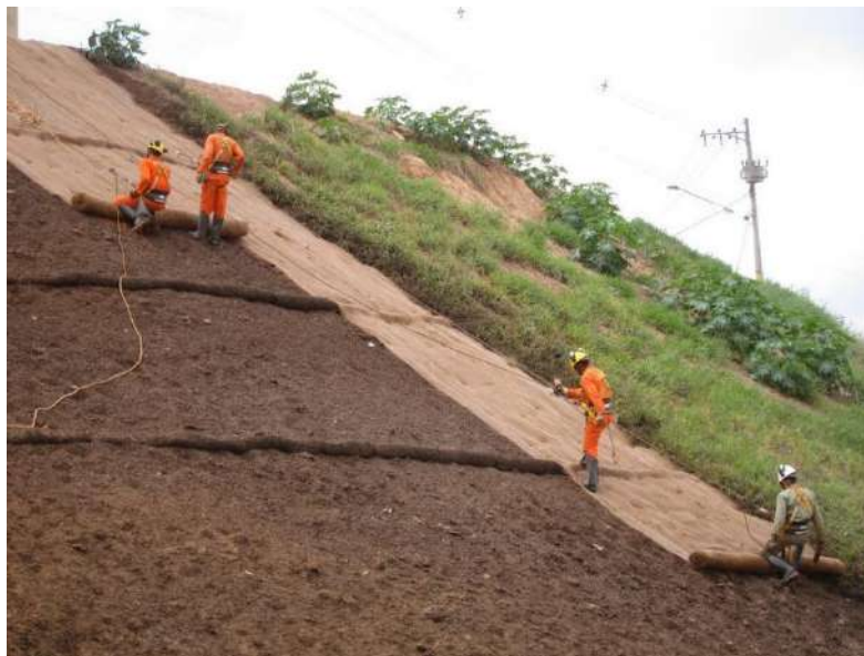
Figura 3. Aplicação de biomanta em talude na região de Nazaré Paulista (Fonte: LinkedIn, acesso em 19/11/2025 às 14:51 https://www.linkedin.com/pulse/an%C3%A1lise-da-viabilidade-aplica%C3%A7%C3%A3o-das-t%C3%A9cnicas-de-e-na-navarro-silva/ ).
