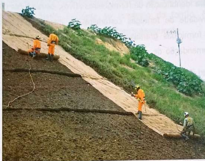
Figura 3. Aplicação de biomanta em talude na região de Nazaré Paulista (Fonte: LinkedIn, acesso em 19/11/2025 às 14:51 https://www.linkedin.com/pulse/an%C3%A1lise-da-viabilidade-aplica%C3%A7%C3%A3o-das-t%C3%A9cnicas-de-e-na-navarro-silva/ ).
