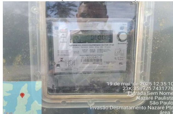
Área 1 Foto 12 – Detalhes do poste de energia e instalador – medidor nº B2320542-7.
