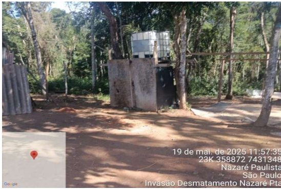
Área 3 Foto 31 – Supressão vegetal e construção de alvenaria na área da Sabesp.
