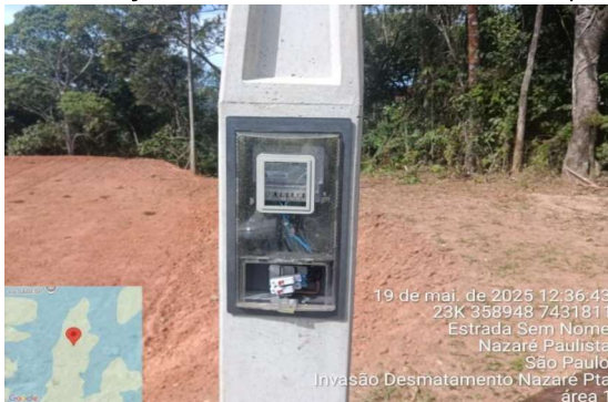
Área 1 Foto 11 – Instalação de energia dentro da área de Sabesp.
