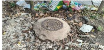
Figura 08. Poço de Visita do sistema de esgotamento sanitário do Jardim Pararangaba, próximo à Rua Rio Jurubatuba (foto 7).
