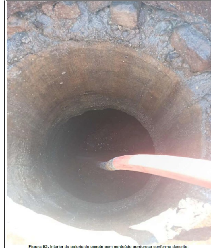
Figura 02. Interior da galeria de esgoto com conteúdo gorduroso conforme descrito.
