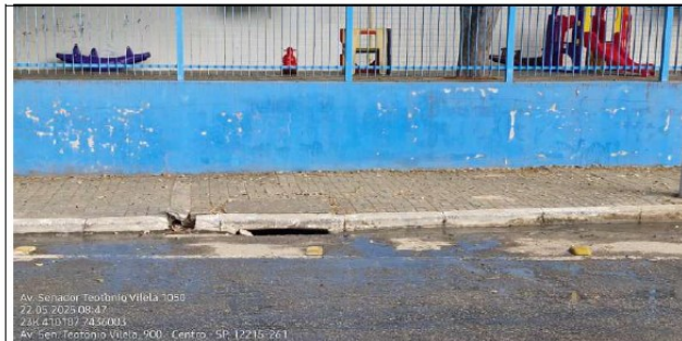
Figura 03. Localização da boca de lobo que desovava o extravasamento do esgoto.
