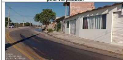
Registro fotográfico 06. Esgoamento do efluente escoando próximo à residências.
