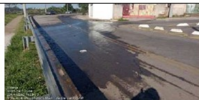
Registro fotográfico 07. Esgoamento do efluente pela via pública.
