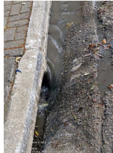
Figura 04. Detalhe da boca de lobo.
