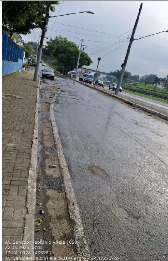
Figura 02. Trajeto percorrido pelo esgoto extravasado, desde sua origem.
