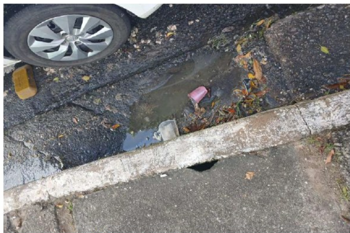
Figura 06. Poça com água contaminada com efluentes do esgoto.
