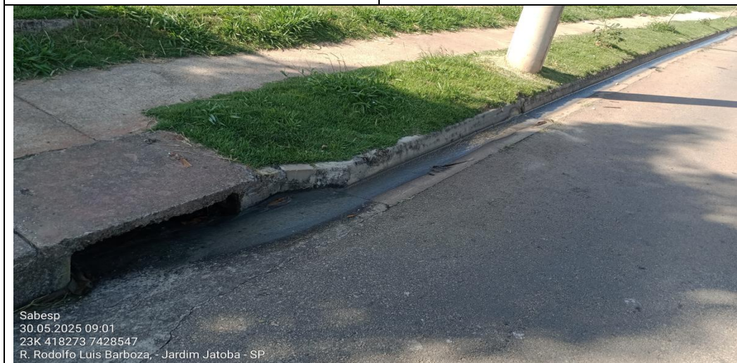
Registro fotográfico 10. Escoamento do efluente para dentro da boca de lobo.
