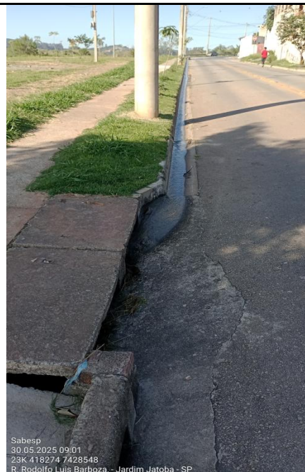
Registro fotográfico 09. Escoamento do efluente para dentro da boca de lobo.
