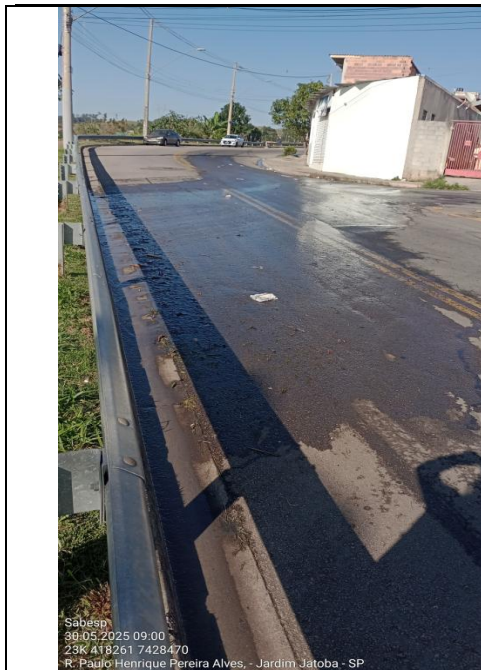
Registro fotográfico 08. Escoamento do efluente pela via pública.
