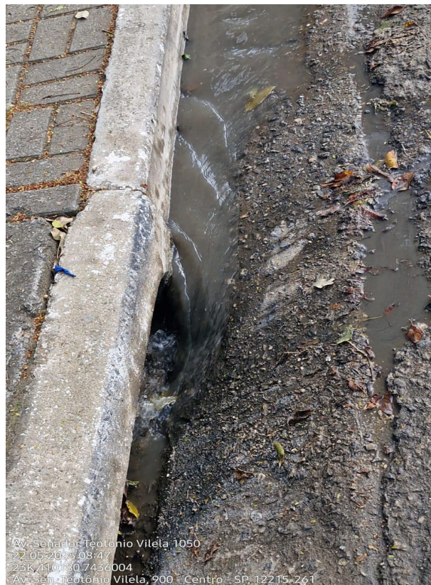
Figura 04. Detalhe da boca de lobo.
