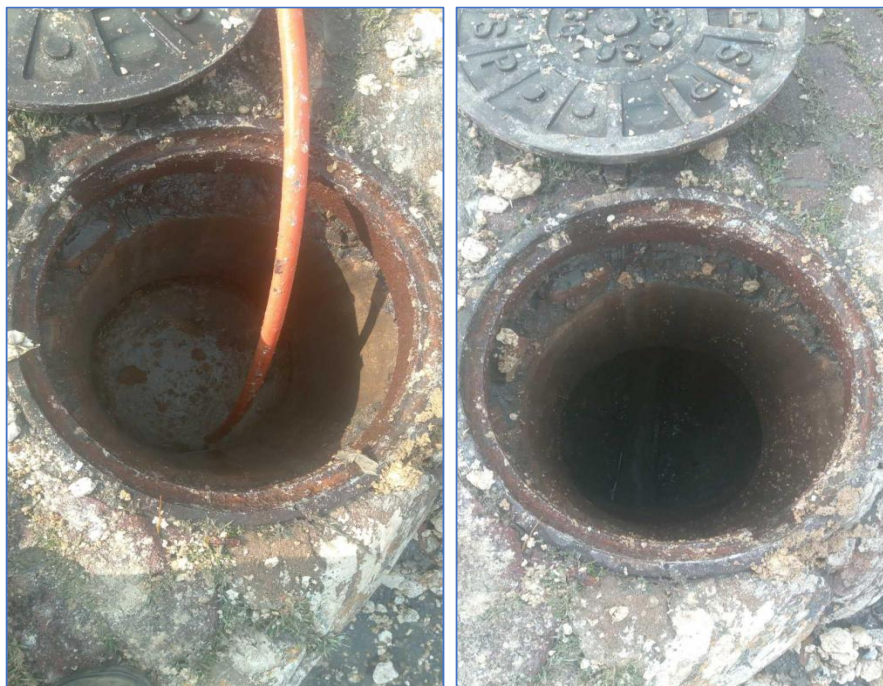
Imagem 6 e 7: OS nº2520753904 – Execução do serviço de limpeza e desobstrução de rede (foto da esquerda durante o serviço, foto da direita mostrando a rede já operando normalmente)
