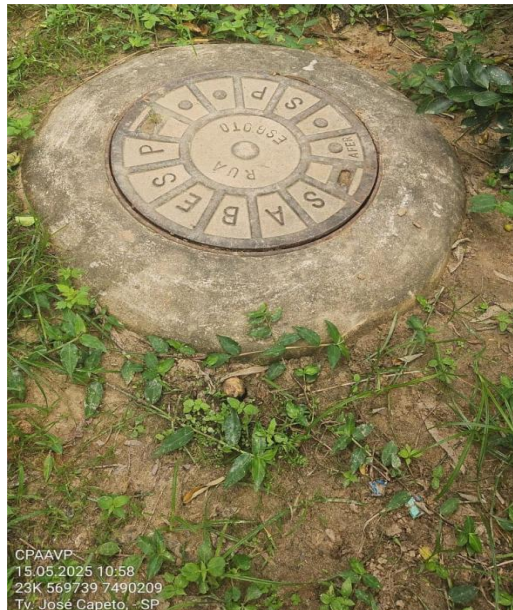
Figura 5: Poço de visita, observado próximo ao ponto de vazamento.
