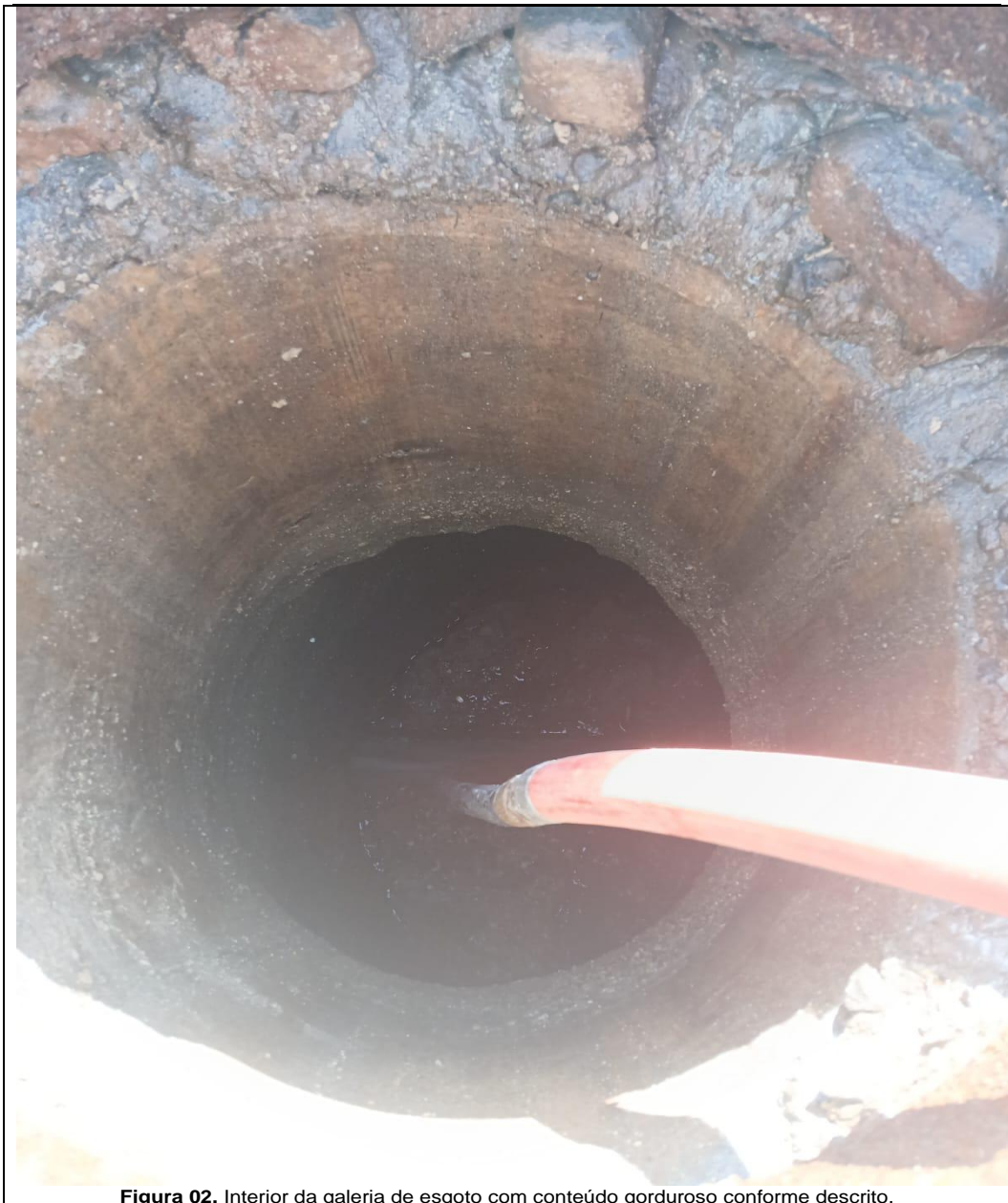
Figura 02. Interior da galeria de esgoto com conteúdo gorduroso conforme descrito.
