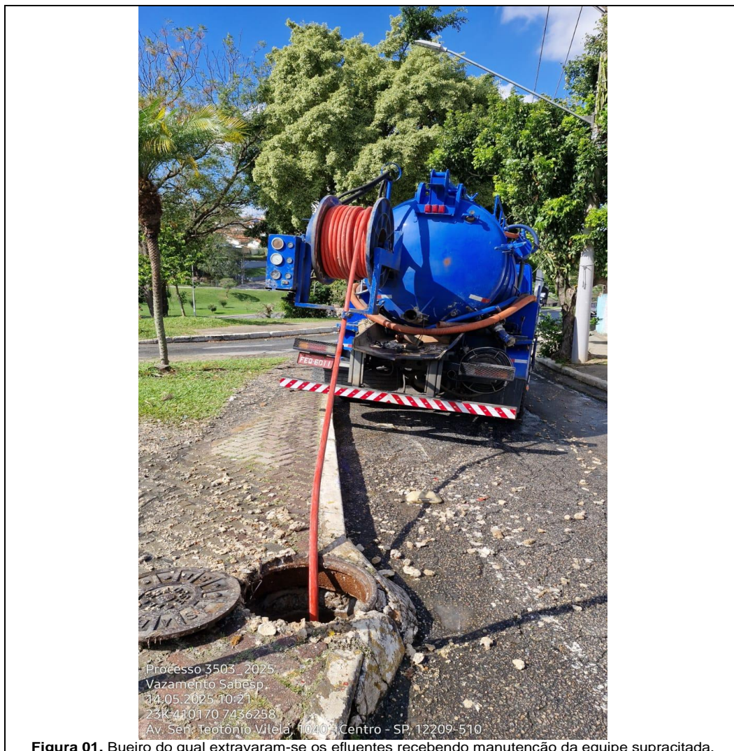
Figura 01. Bueiro do qual extravaram-se os efluentes recebendo manutenção da equipe supracitada.
