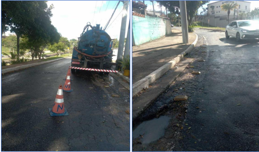
Imagem 3 e 4: OS nº2519737718 equipe iniciando o serviço de limpeza e desobstrução de rede
