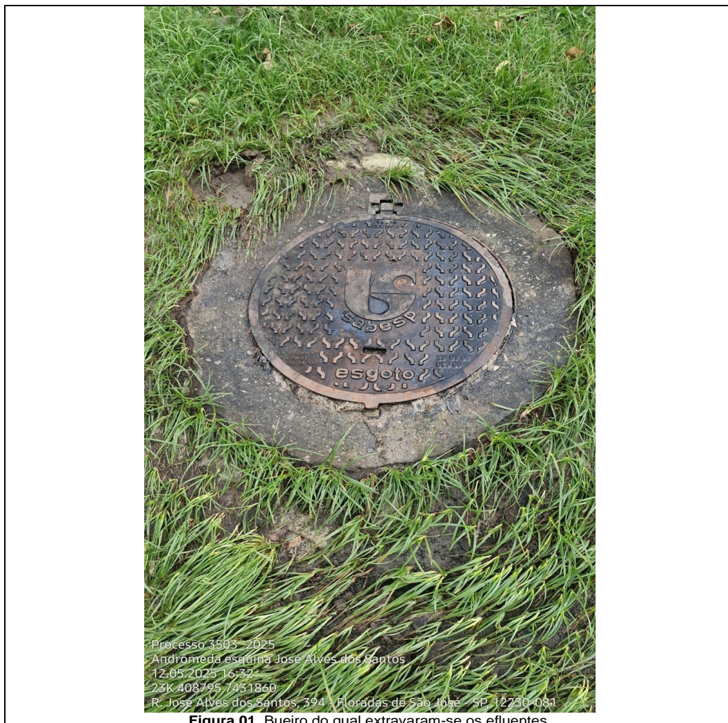
Figura 01. Bueiro do qual extravaram-se os efluentes.
