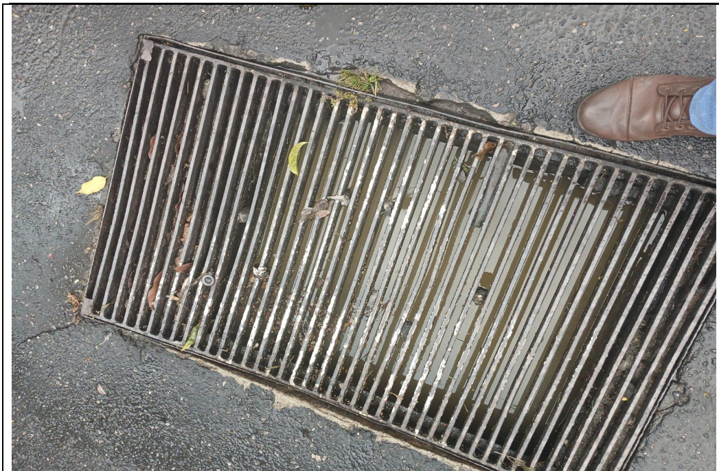
Figura 04. Galeria pluvial cheia.
